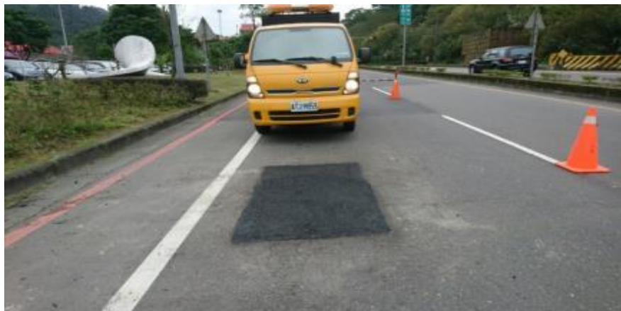
圖 8 熱再生修補路面工法修補寬度未達車道寬現況示意照片
